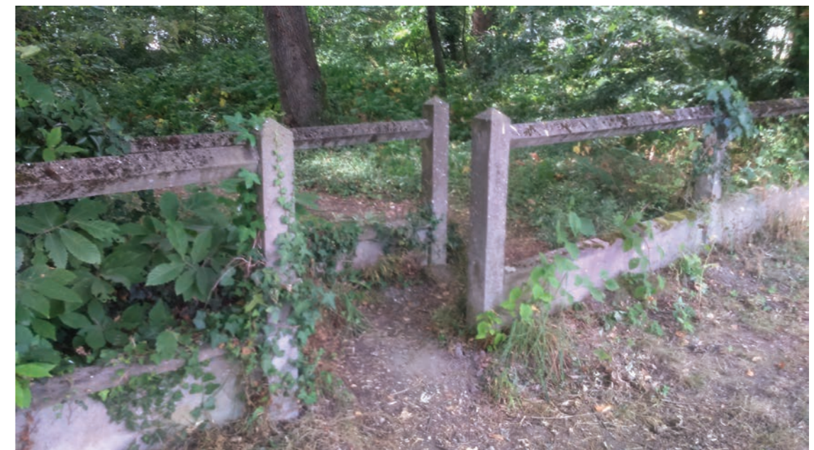
Entrée piétonne officielle nécessitant un réaménagement
