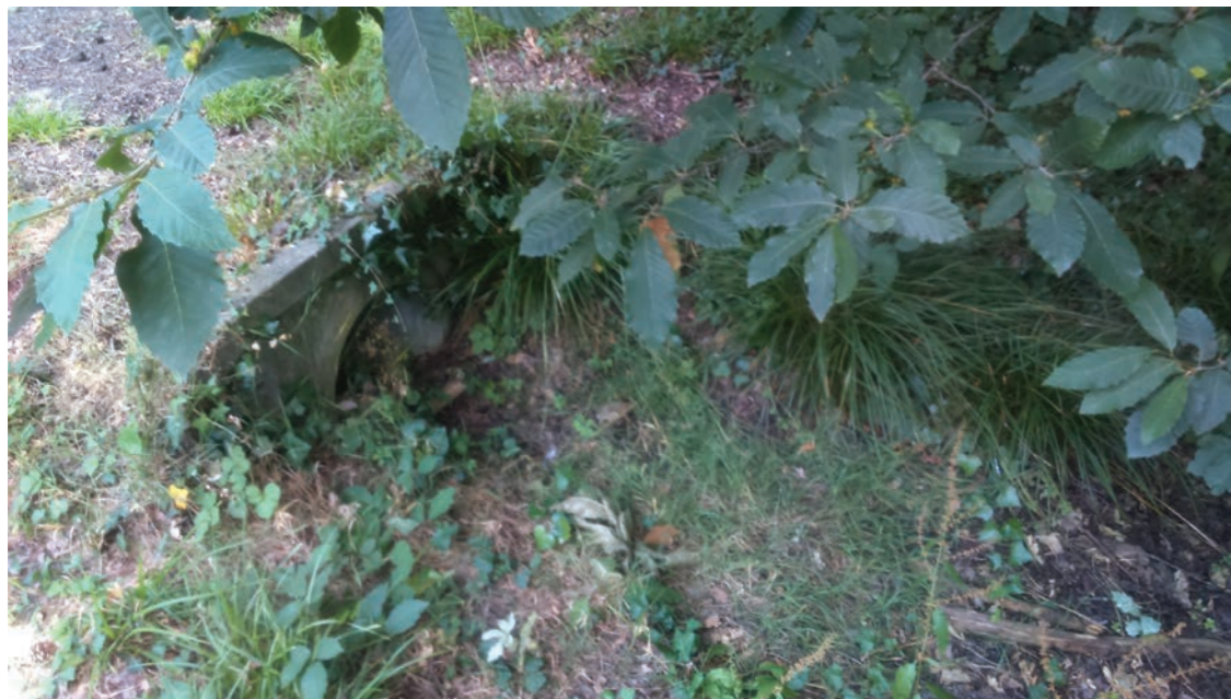
Buse d'évacuation d'un fossé quasiment obstruée
